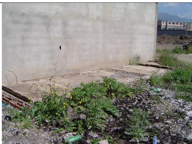
Fosse de décantation de l'huilerie
