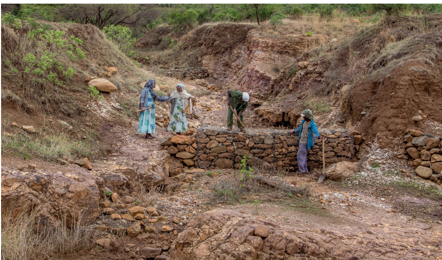
Des habitants effectuent des vérifications sur les gabions, à la recherche de pierres détachées, dans le cadre de la maintenance d'un barrage, à Tahtay Maichew, Kebele.
