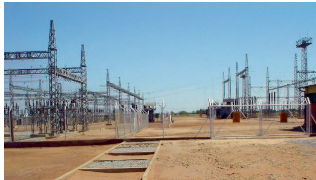
Integrated electricity networks and „smart“ grids will be needed. The Gerus Substation in Namibia. Des réseaux électriques intégrés et des réseaux « intelligents » seront nécessaires. La sous-station de Gerus en Namibie.
