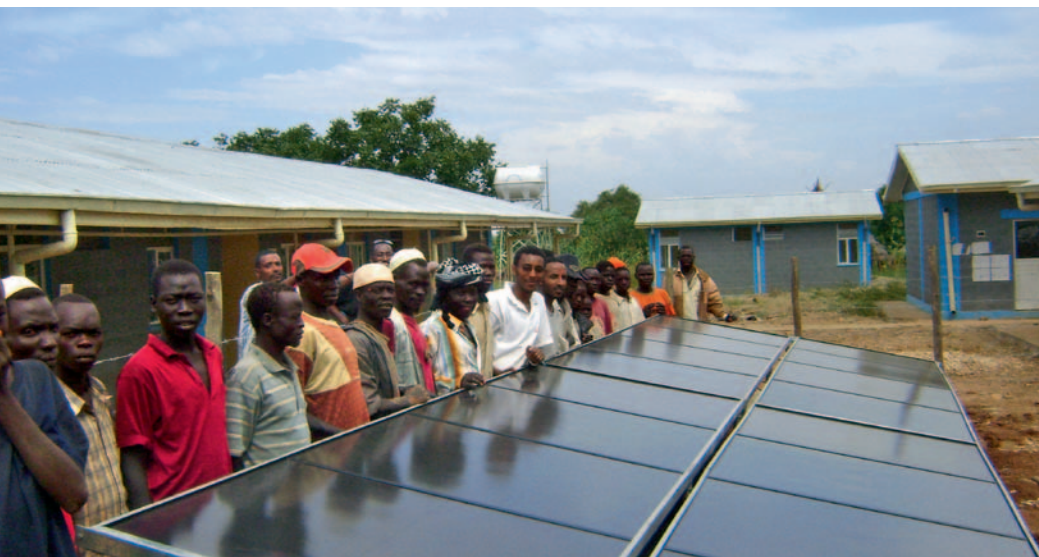
Solar photovoltaics installation at a health clinic in rural Ethiopia. Installation solaire photovoltaïque dans un centre de santé rural en Éthiopie.
