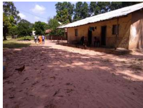
Fornecimento de energia a residência a partir do gerador central, localizando em Sansambato.
