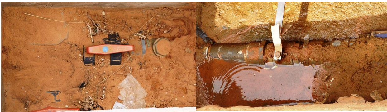
Absence d'entretien (ouvrage enterré et fuite) sur le refoulement et la distribution du réseau
