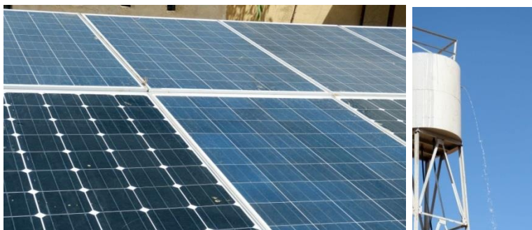
CSCOM de Sékoro : Gauche : l'assemblage des panneaux solaires monocristallin (sombre) et polycristallin en série compromet la durabilité de l'installation. Droite : le château d'eau déverse signalant une vanne défective. La réparation à faire est simple mais ni l'ASACO, ni COOPI ne l'a entreprise..
