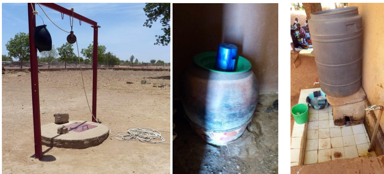
Gauche et Centre :CSCOM de Tongo : source et stockage de l'eau de boisson non sécurisé. Turbidité supérieure à 5 NTU (10) et absence de chloration.
