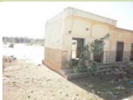
28. ZONE SENSIBLE – INONDATION : Résultat de l'initiative de l'image précédente. Construire en brique n'est pas la solution au problème d'inondation
