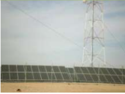
29. ENERGIE RENOUVELABLE : Installations de panneaux photovoltaïques
