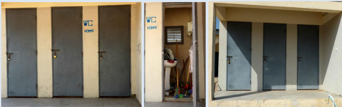
Bloc de six latrines à proximité des services de l'hôpital de Baga Sola dont l'accès est verrouillé pour 5 d'entre elles, la dernière servant de remise.
