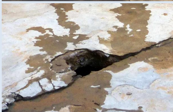
Latrines défectueuse (porte descellées et dalles dégradées) du UNT
