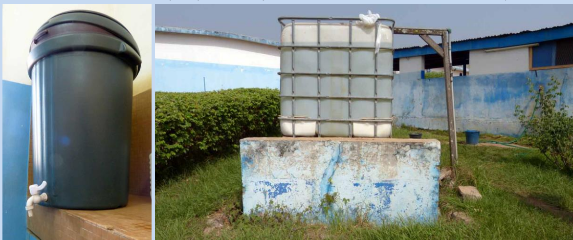
En milieu urbain les mêmes lacunes existent avec des solutions soit insuffisantes (photo de gauche : réservoir de contingence de 80 litres à Grand Gbapleu) soit non fonctionnelles (photo de droite, container de 1 m 3 non raccordé au reste du CSU de Libreville).
