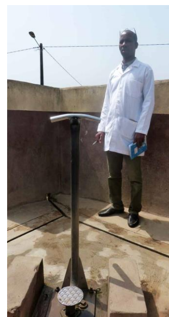
Pompe vergnet de Gbantongouin installée en juin 2016
