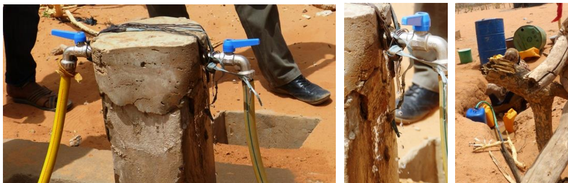
Autre exemple de préemption du réseau ACF de M'Béra 2 : le raccordement a été fait cette fois sur la borne fontaine. En jouant avec le robinet, les enfants ont détérioré le raccord et occasionné une fuite permanente qui diminue d'autant la quantité d'eau disponible sur le réseau.
