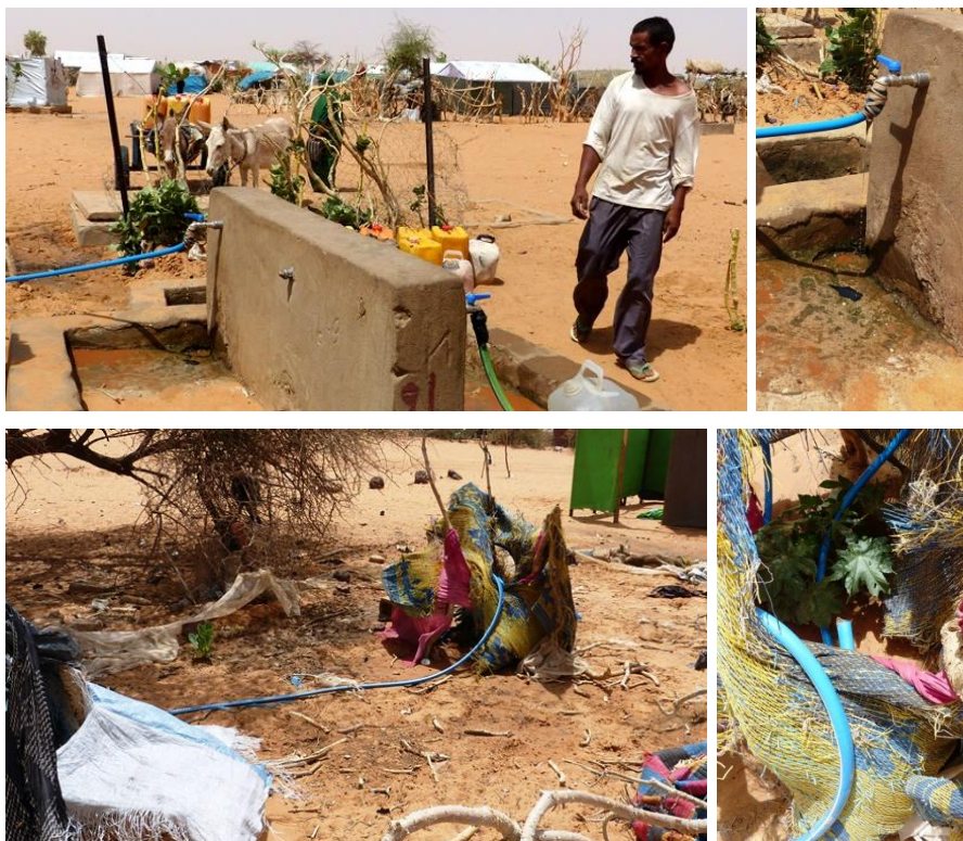
Ci-dessus en haut : des raccordements illicites au niveau d'une borne fontaine du camp. L'absence d'étanchéité de ces raccords conduit à des fuites permanentes sur le réseau.
