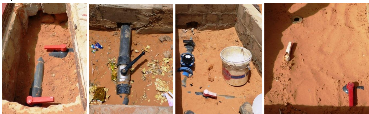
Absence de curage sur la plupart des boîtes de protection des ouvrages de connexions du réseau
