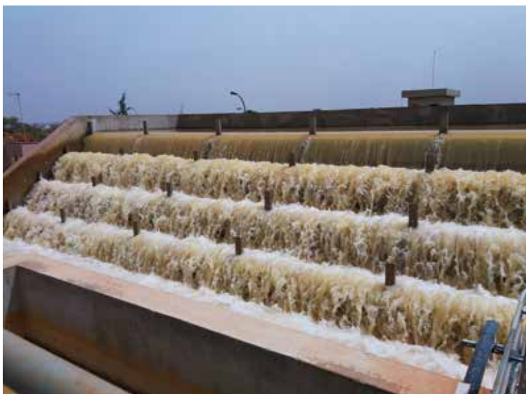
Usine de traitement de l'eau, Ziga II
