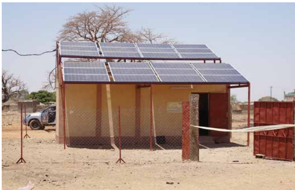
Une mini-centrale solaire inaugurée le 31 mars 2017
