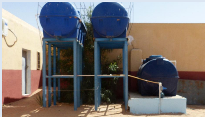
Les deux réservoirs préexistants (à gauche) et la citerne de 3 m 3 et sa pompe de relèvement mise en place dans le cadre de l'action (à droite)
