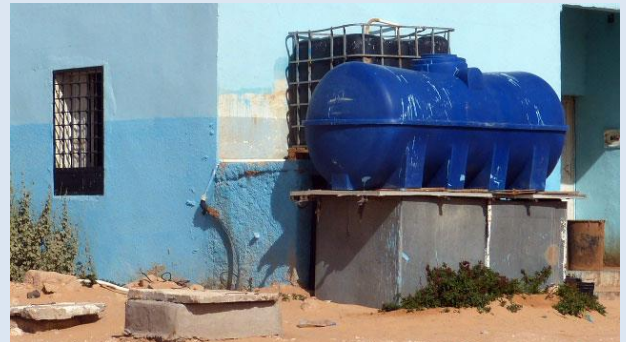
Citerne de 1 m 3 alimentant la cuisine de l'école.
