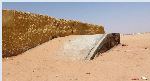
Rampe d'accès des camions-citernes au réservoir de stockage à l'extérieur de l'enceinte de l'établissement réhabilité par CISP dans l'école d' Undraiga (Camp de Laayoune)
