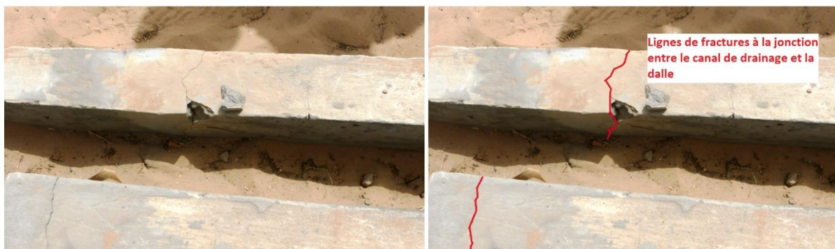
Malfaçon dans la conception et/ou l'exécution des ouvrages de surface au niveau des bornes fontaines.
