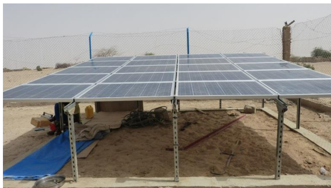
Panneaux solaires mis en place par ACTED sans ligne de secours
