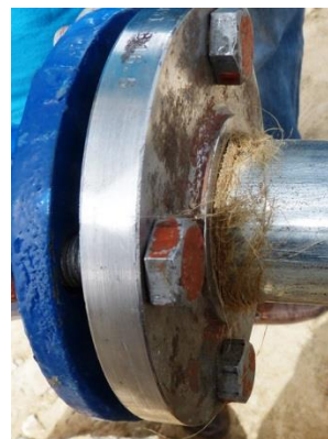
Joints mal assurés avec de la filasse
