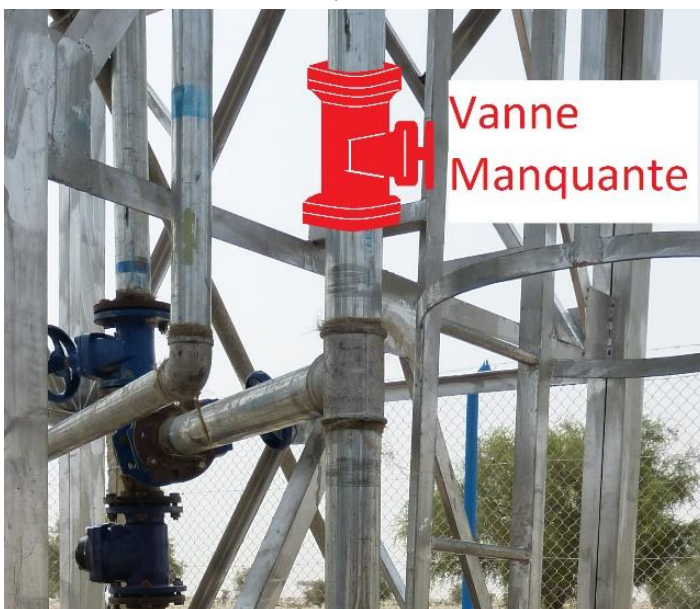
Vanne manquante matérialisée en rouge sur la photo ci-dessous pour garantir la fonctionnalité du by-pass de l'ouvrage de stockage.
