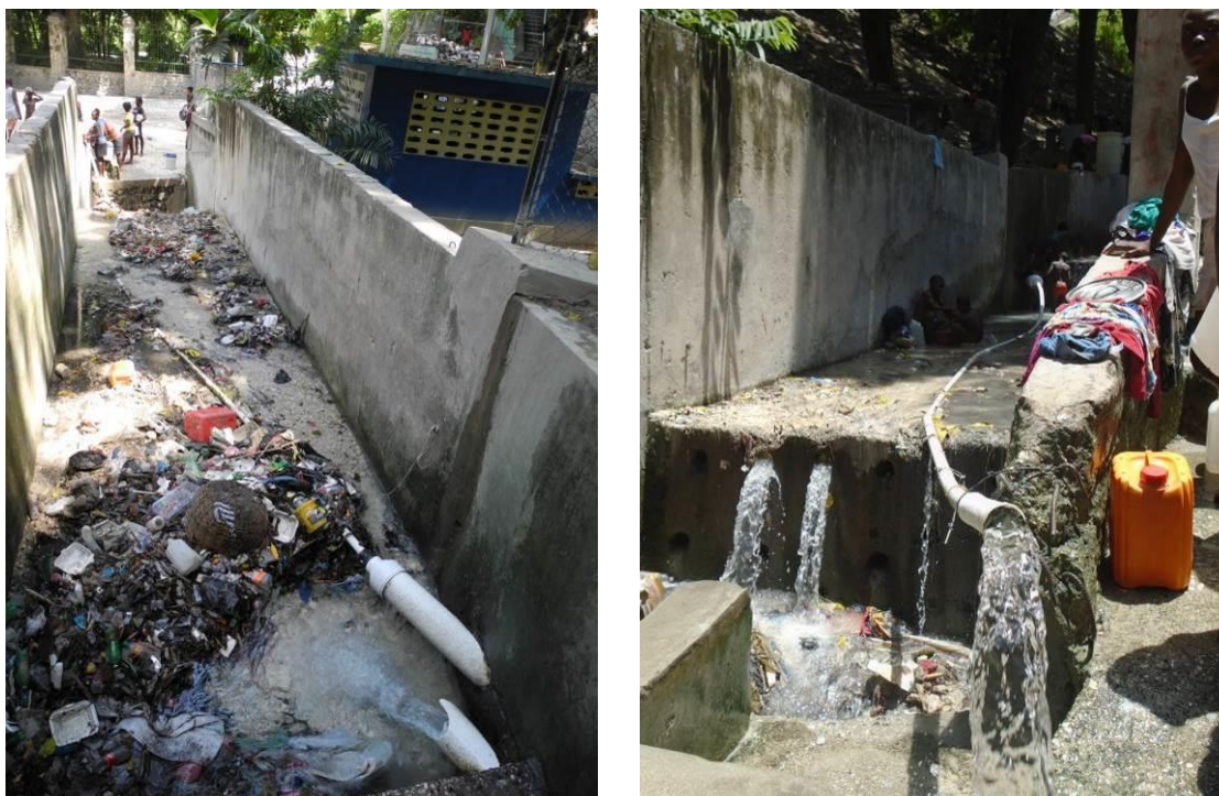
Figure 36 : vues du dégraveur à l'entrée de la Vallée du Repos. Les deux tuyaux sur la photo à gauche sont les trop-pleins de la source Leclerc ; le tuyau PVC sur la photo à droite a été installé par les « trafiquants d'eau » pour faciliter le branchement des motopompes (voir ci-après)
