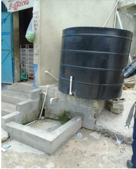
Figure 33 : réservoir privatif à Sorey
