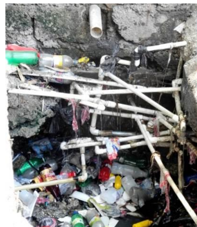
Figure 47 : réseau de prises probablement illégales au niveau de la RN2.
