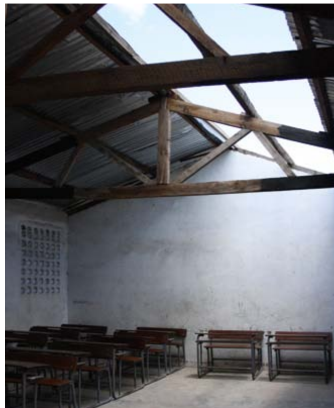
Figura 3: Escola danificada pelo Ciclone Funso em Pebane, Moçambique.
