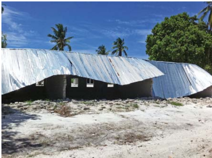
Figura 11: Construção deficiente ou pouca consideração quanto ao risco de exposição pode originar danos estruturais importantes, como se vê aqui, em Moçambique.
